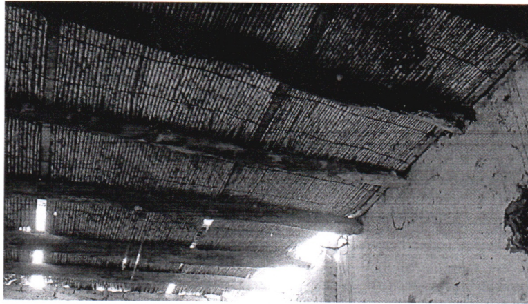
Filtraciones en Cubiertas de techo
