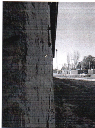
Apreciable pérdida de verticalidad de muros de adobe
